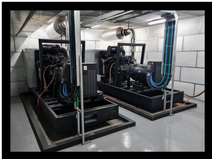
ATUALMENTE: 2 GERADORES DE 350 KVA
