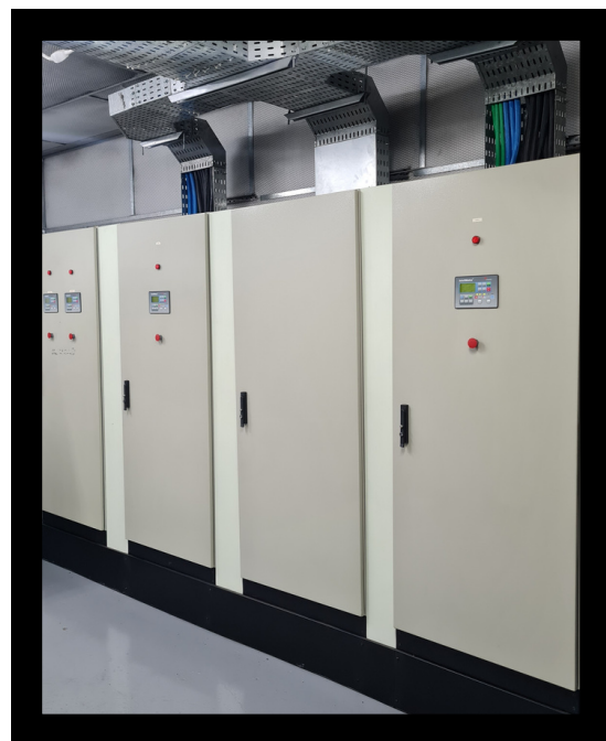
QUADRO DE TRANSFERÊNCIA AUTOMÁTICO - QTA
