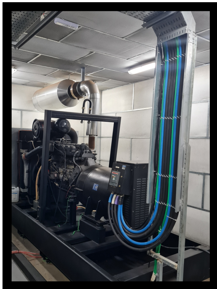
CABOS 3 FASES - CADA FASE COM 2 CABOS DE 240 MM
